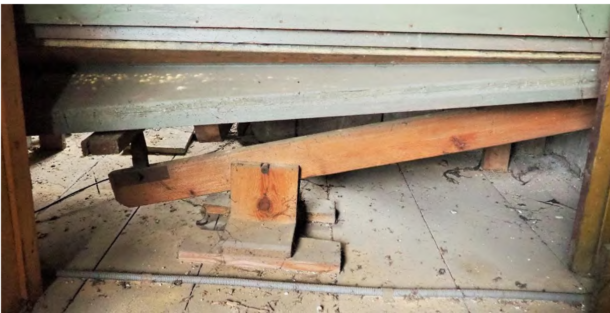
Fot. 69. Urządzenie do kalikowania pod miechem pozytywu w kościele par. w Tubądzinie.
